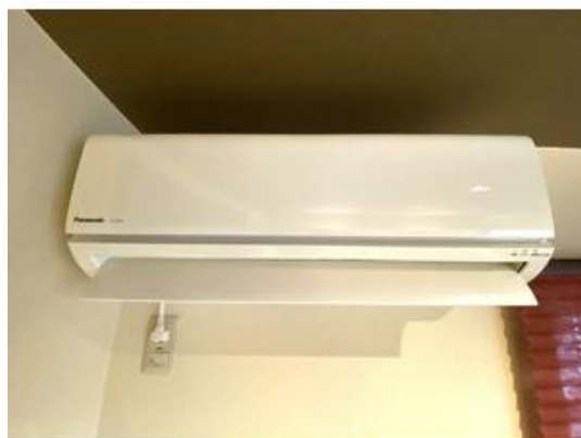
和室:エアコン
