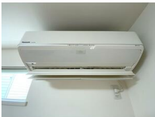
リビング:エアコン
