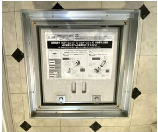
24H換気システム:フィルター・ファン部
